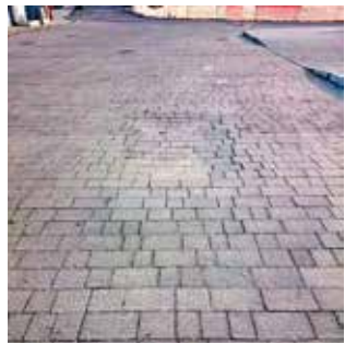
Avvallamenti pavimentazione molo di ponente
